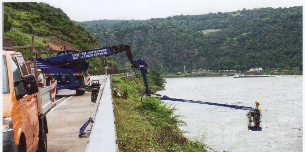
Da wegen eines Hochwassers im Rhein der Zugang zum Ufer versperrt und Arbeiten mit einem Gerüst nicht möglich waren, wurde ein Teleskopstapler TSR 2150 Premium Edition aus der Mietflotte von Beyer-Mietservice für den Einsatz angemietet. Ausgestattet ...
